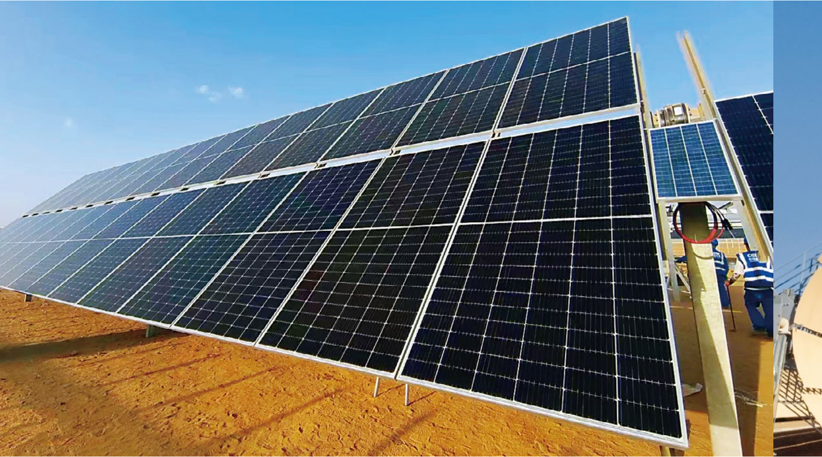
拉比格 300 兆瓦独立太阳能光伏电站项目
