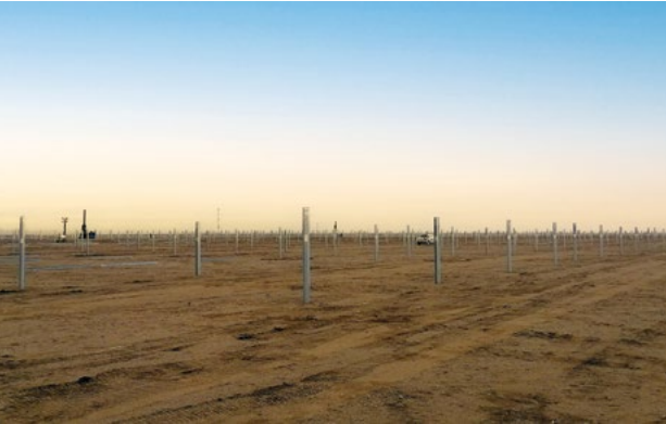
中国通信服务沙特 Rabigh 300WM 光伏电站 EPC 项目，是沙特国家可再生能源计划的一部分，支撑沙特国家转型计划(NTP) 和“2030 愿景”
